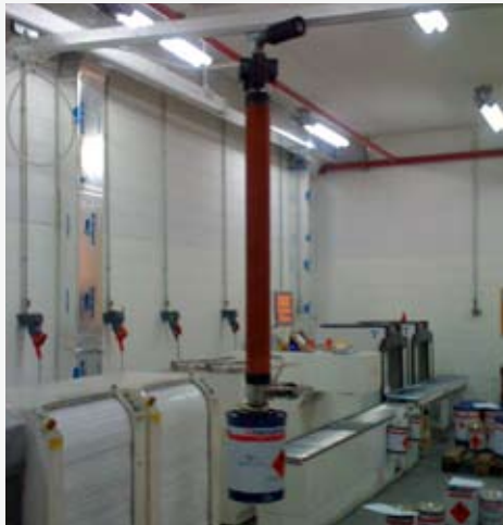
4. Eine Installation in der ATEX zone 1. Der verwendete VM120 wird hier von einer Ejektorpumpe angetrieben. Eingesetzt wird hier der Standardsaugfuß mit der Artikelnr.: 630215.
